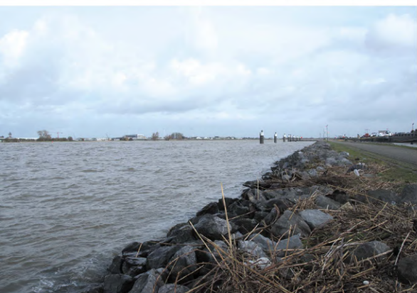
▲ Het snel stromende water achter de doorstroombening in de Bandijk heeft een vier meter diep gat uitgeschuurd. Dat sediment wordt elders weer gedeponerd, Polder Hardenhoek.
